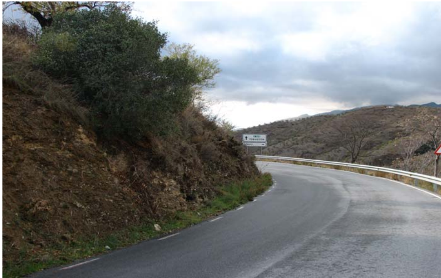
Zona afectada por atalusamiento en el P.K.2+200
