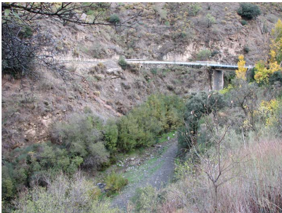
Zona afectada por la Estructura E2 (Barranco de Valdevique).
